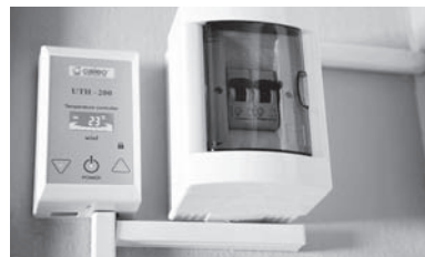
Рис. 20. Терморегулятор, подключенный к сети через отдельный автомат
